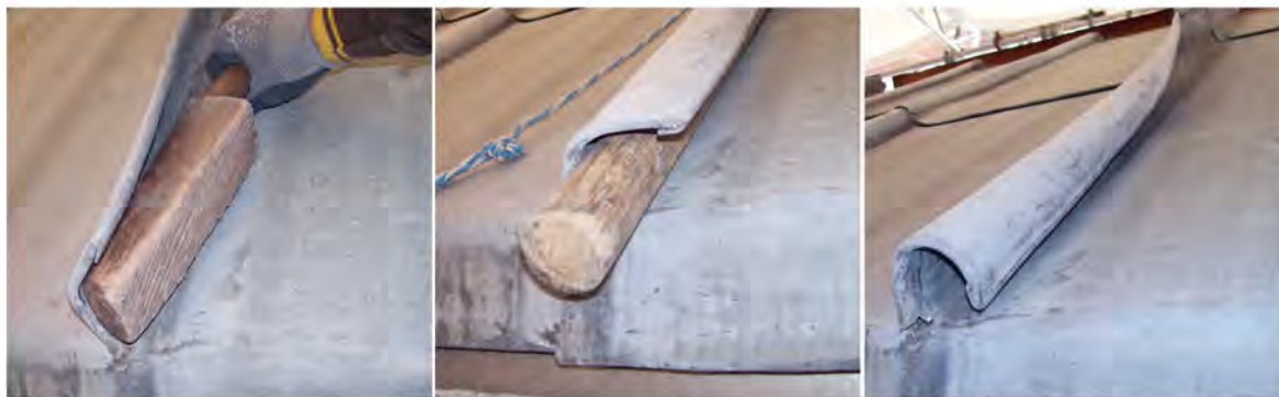
Die Herstellung der 60-mm-Rundfalze erfordert handwerkliches Geschick. Adolf Heinzinger verbindet einzelne Bleiplatten über entsprechenden Rundholzleisten. Das Gefälle der gewaltnen Gaubendächer wurde zuvor erhöht. Eine 27-mm-Dreischichtplatte dient als vollflächige Auflage für die neue Bleieindeckung
